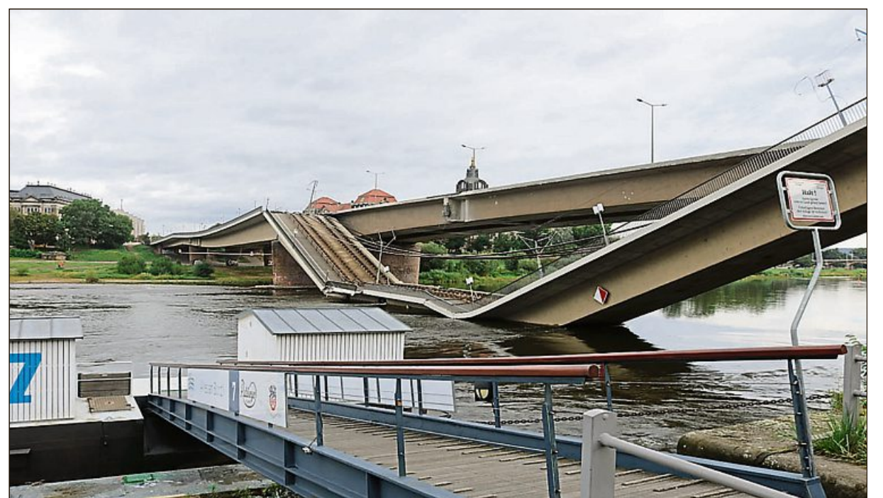
Die eingestürzte Carolabrücke in Dresden.
